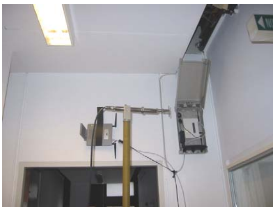
Foto 14: Testinstallation Accesspoint vor Raum S2300
